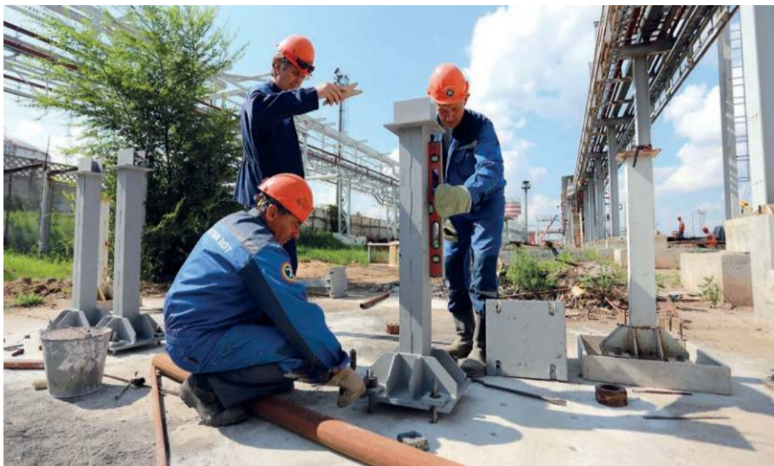
Бетонщик Александр Школин, каменщик Владимир Ганченков и монтажник Николай Макаров монтируют опоры трубопроводов на складе метанола
